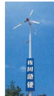
風力発電設備
